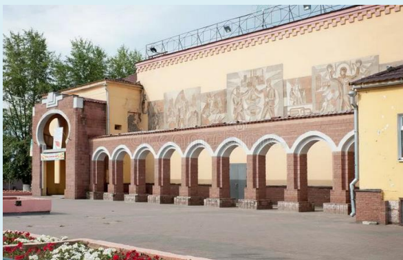
Здание Районного дома культуры до проведения ремонта, запланированного на 2024 год
