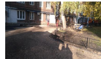
Выполнение работ по благоустройству дворовой территории г. Балахна ул. Свердлова (дома №7,8,11,12) в 2022 году
